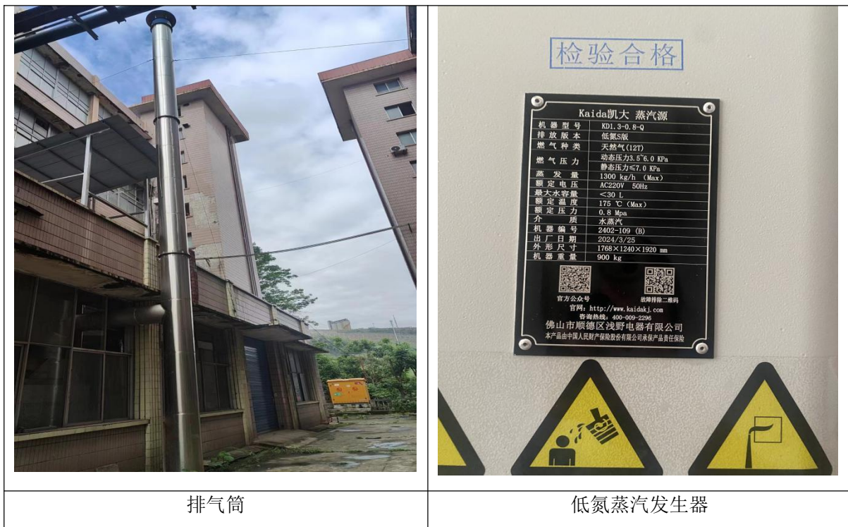
4.1 废气处理设施现场图
