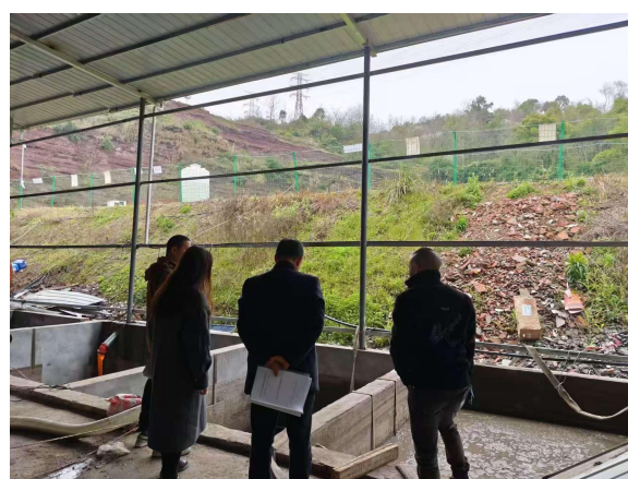
废水处理设施
